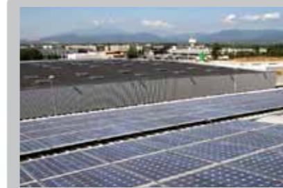
Projecte solar fotovoltaic sobre la coberta de la nau 8 del CIM El Camp
